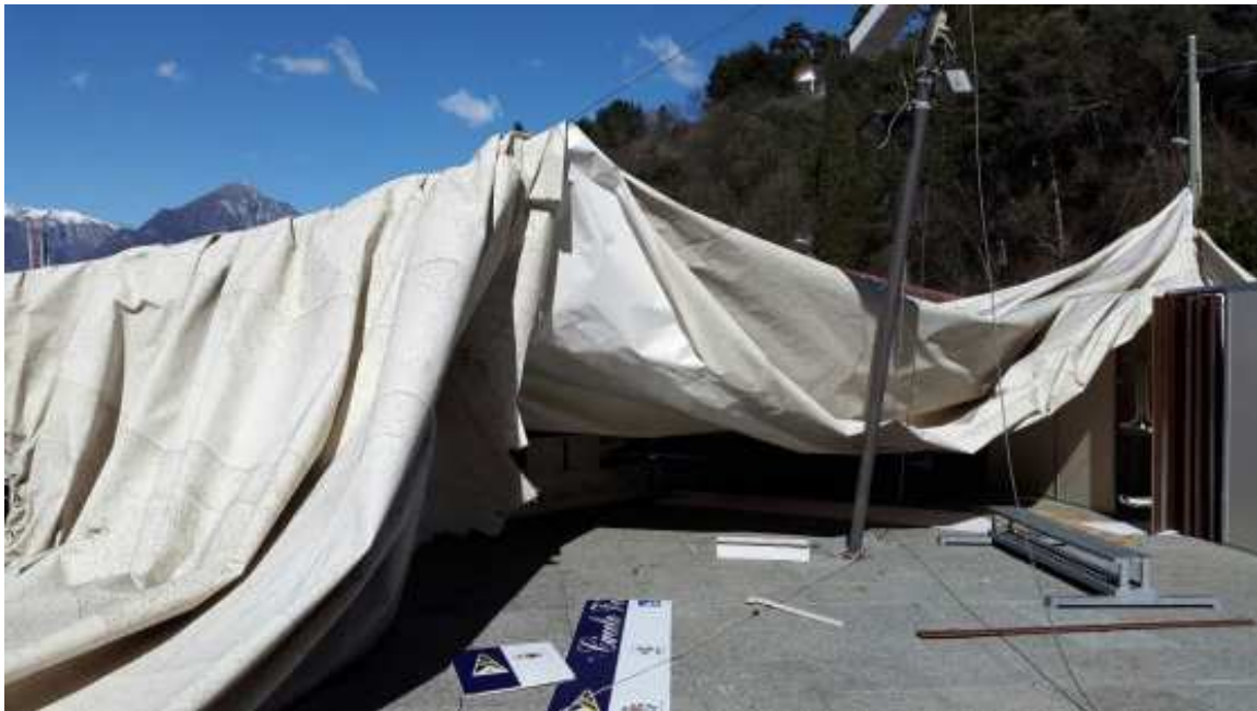
Figura 9: Torbole: danni alla tensostruttura al Circolo Vela..
